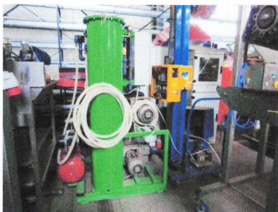
Fot. 25. Generator azotu typ ACG28, G0265
